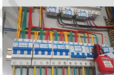
带电设备作业区域
